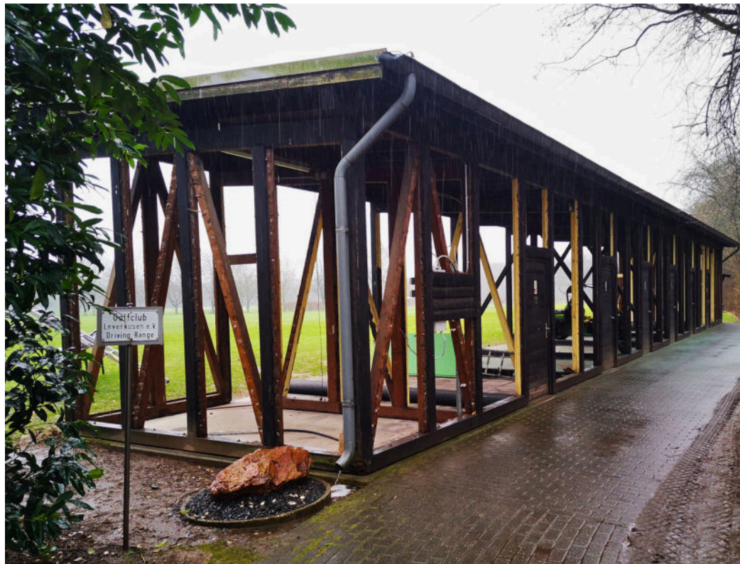
Das sieht nach viel Arbeit aus - das war es auch! Das einstige Konstrukt unserer Abschlagshütte konnte aber erhalten bleiben.
